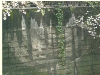
風で左右に揺らされているつる植物 動揺が続くと天端角部で切れてしまう
